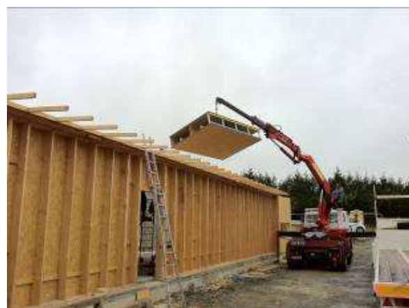
Une structure de caissons bois, entièrement réalisée en atelier, facilitant le travail des ouvriers.
